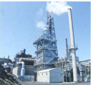
DATA ▶ 八戸製錬株式会社殿向 【発電所ボイラー排ガス対策設備】 2008年1月施工
