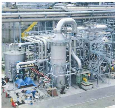
DATA ▶ 三菱製紙株式会社殿向 【臭気ガス設備】 2009年6月施工
